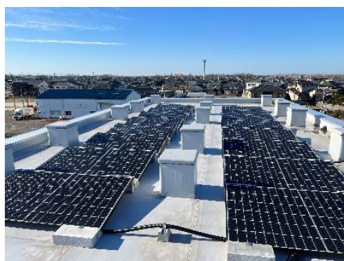
あおい幼稚園の「そらべあ発電所」太陽光パネル
