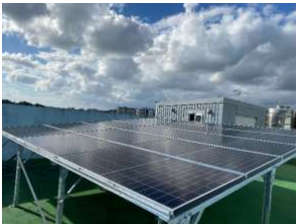
すだつ保育園に設置された太陽光発電設備
