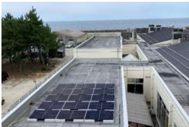
かいけ心正こども園に設置された太陽光発電設備
