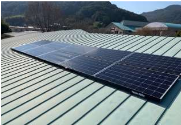
もりやまこども園に設置された太陽光発電設備
